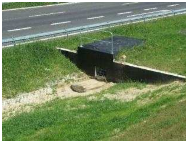
Zdjęcie 19. Niezabezpieczony wlot do budowli systemu odwodnienia drogi - Puławy
